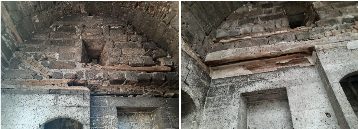
Şekil 2.7. Surp Sargis Kilisesi Orta Apsis bölümündeki ahşap malzeme ve duvarlarda meydana gelen bozulmalar
