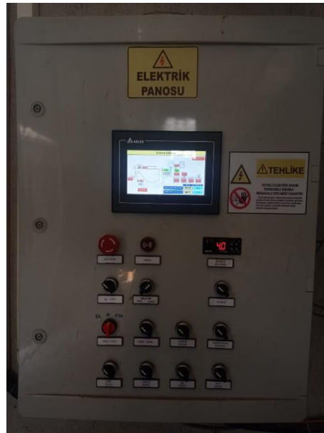
Şekil 6. HMI Dokunmatik Paneli Ve Manuel Çalışma Anahtarları
