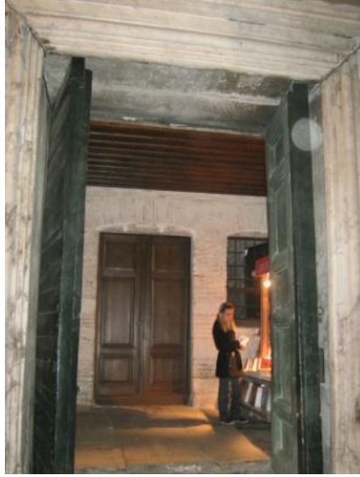
Şekil 3.64. Ayasofya'nın Naos mekânında doğu yan duvarda yer alan üst galeri rampasının çıkış kapısı, (Bilgen, 2011)
