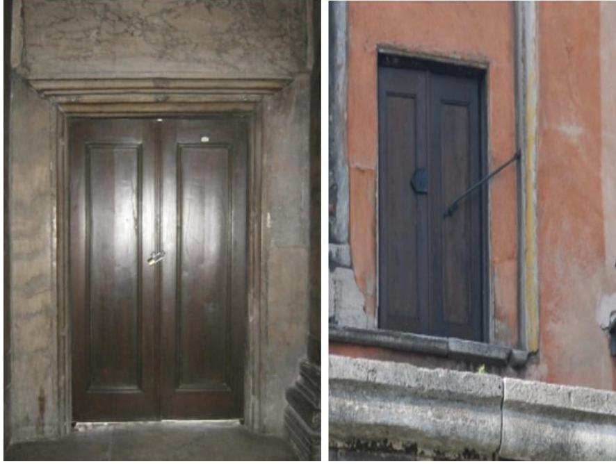
Şekil 3.88. Ayasofya'nın üst katındaki güney galerinin güney yan duvarındaki uçan payandaların iç kısmına bağlanan kapı, (Bilgen, 2011)
