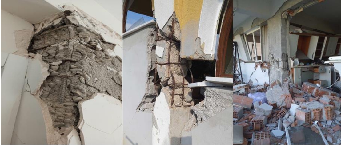
Şekil 3.3. Uygun olmayan ve düşük dayanımlı beton kaynaklı hasarlar
