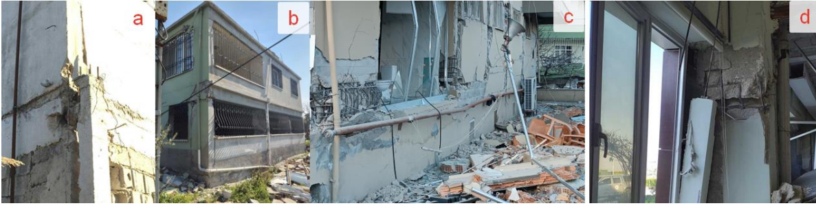
Şekil 3.4. Yetersiz enine ve boyuna donatı sonucu oluşan hasarlar: a) katlar arasında yetersiz donatı kenetlenmesi, b) Kolon-kiriş bölgesinde yetersiz enine donatı, c) Kolon alt sarılma bölgesinde yetersiz nine donatı, d) Kolon üst sarılma bölgesinde yetersiz enine donatı
