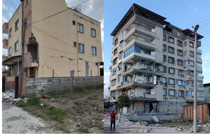
Şekil 3.9. Kapalı ağır çıkma kaynaklı oluşan hasar örnekleri
