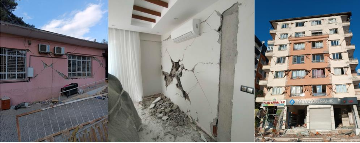
Şekil 3.7. BA yapılarda kullanılan bölme duvarlarında meydana gelen hasarlar
